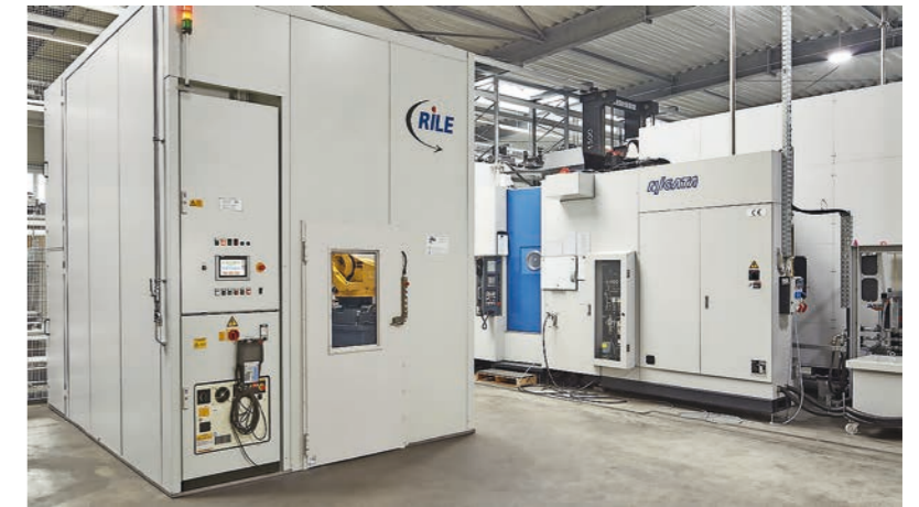
Entgratroboter in seiner Schallschutzeinhausung. Gesteuert wird aber über das CAM-System. Der Bediener gibt die gewünschten Kanten sowie die Tiefe der Fasen und Bohrungen einfach am PC ein.
